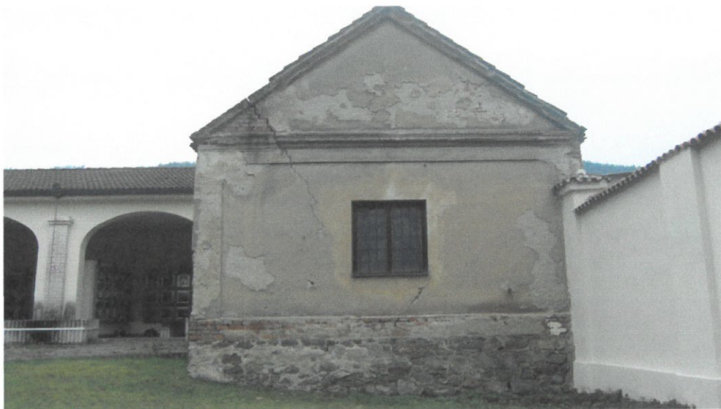
Pohled na jižní fasádu objektu porušenou šikmými trhlinami. Vlivem dlouhodobého zatékání došlo k podemletí poklesu jihozápadního rohu objektu
