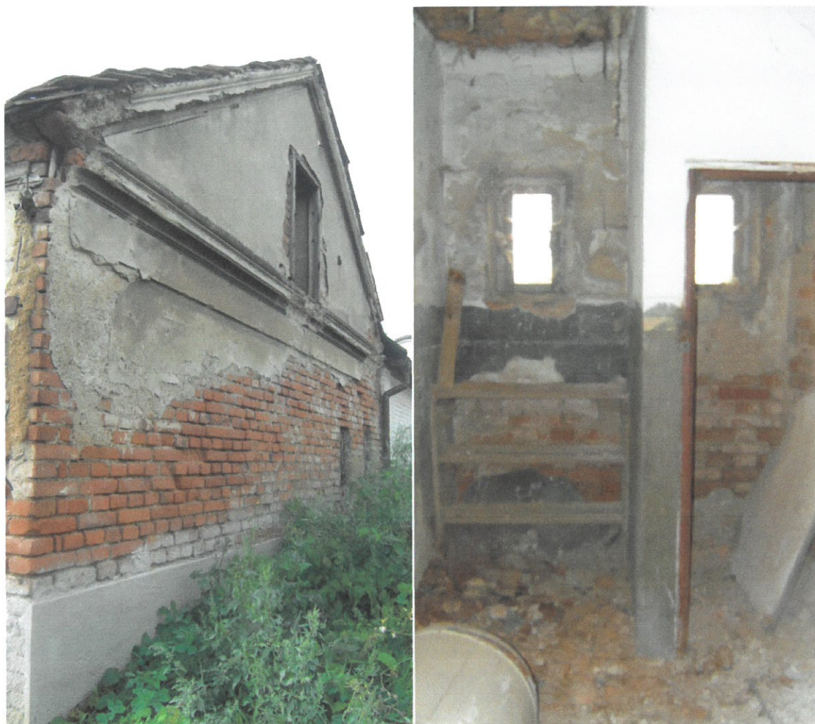
Pohled na provedenou sanaci vnějšího zdiva márnice a současný stav vnitřního zdiva. Zdivo severní zdi je relativně suché
